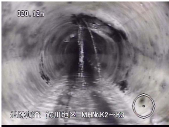
写真10 浸入水状況 (本管のみ更生)
